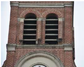
Exemple d'une antenne relais intégrée (église de Râches)
